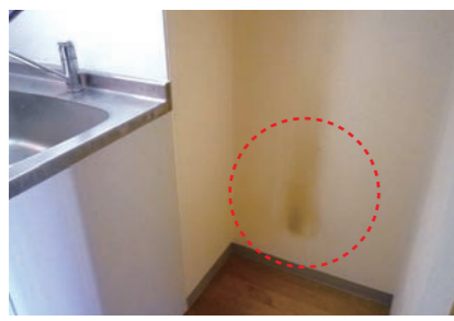
冷蔵庫の後部壁面の黒ずみ(電気ヤケ) 通常の使用による損耗⇒ 貸主負担
